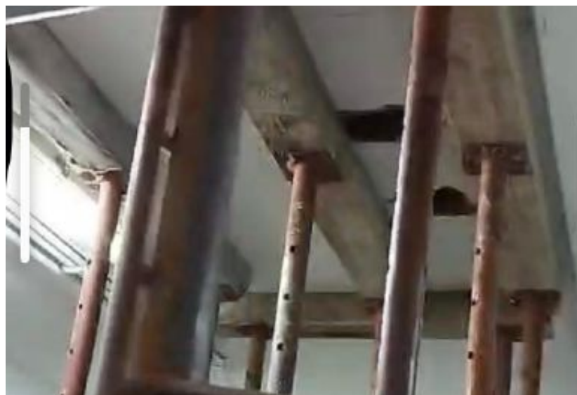
Emergenza Per ovviare alle carenze strutturali Apss era intervenuta puntellando i piani
